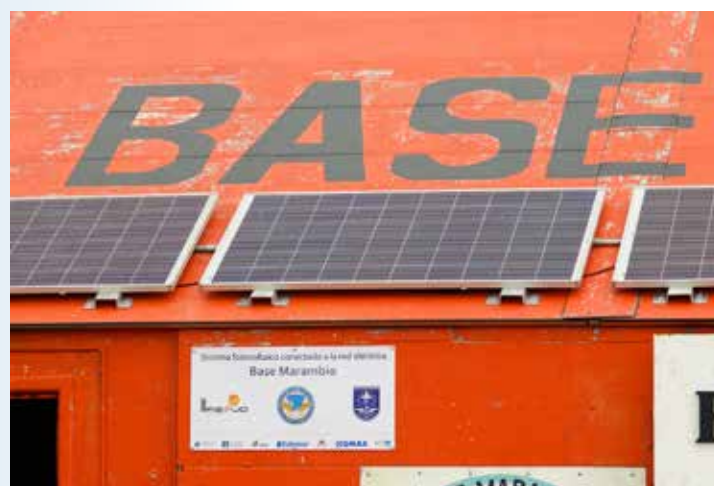
Figura 5: Sistema fotovoltaico instalado en la Base Marambio, Antártida Argentina.
