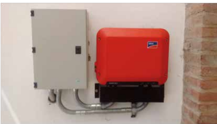
Figura 4: Protecciones, medidor e inversor.
