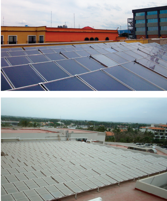
Fig. 3.1.6. Instalaciones de sistemas solares para sector servicios. (Fotos cortesía de Módulo Solar S.A de C.V).
