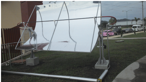
Figura 2.4.7. Mecanismo de seguimiento solar. (Cortesía del INEEL).
