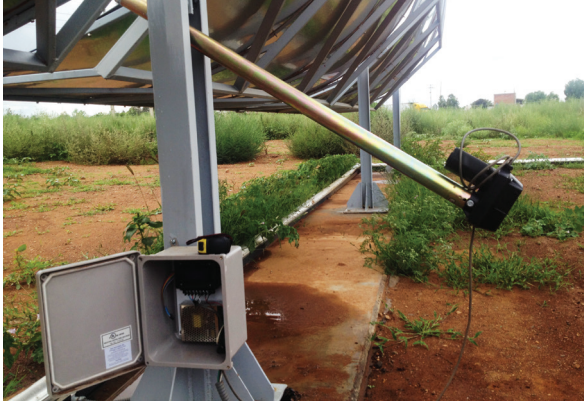
Figura 2.4.8. Control automático. (Planta Experimental de Secado Solar en Zacatecas).
