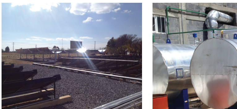
Figura 2.4.9. Transporte y almacenamiento térmico. (Planta Experimental de Secado Solar en Zacatecas).
