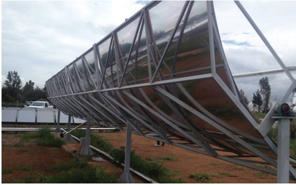
Figura 2.4. 4. Estructura de soporte. (Planta Experimental de Secado Solar en Zacatecas).
