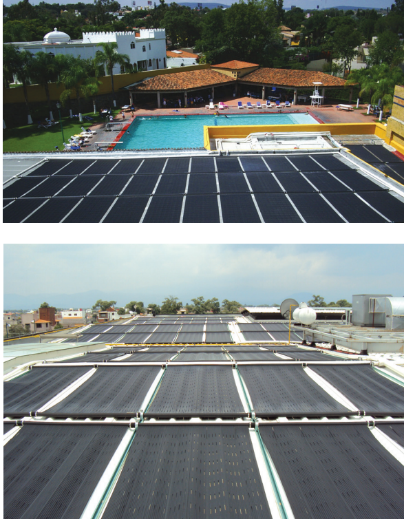
Fig 3.1.3. Instalaciones de sistemas solares para piscinas. (Fotos cortesía de Módulo Solar S.A de C.V).
